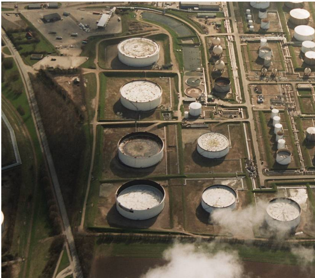
Figur 5-4 Luftfoto af flydetagstanke og Asnæsvej til venstre i billedet. På tankene i forgrunden kan tydeligt ses, at flydetagene er sænket.
