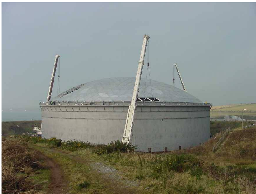
Figur 2-4 Illustration af påsætning af kuppeltag på tank. Her er dog tale om en tank med en diameter på 83 m mod til sammenligning 75 og 50 m på de nye tanke. © CTS B.V. Rotterdam.
