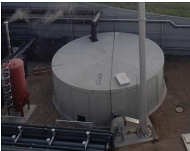
Figur 20: Foto af biofilter på Horsens Bioenergi inkl. afkast/skorsten.
