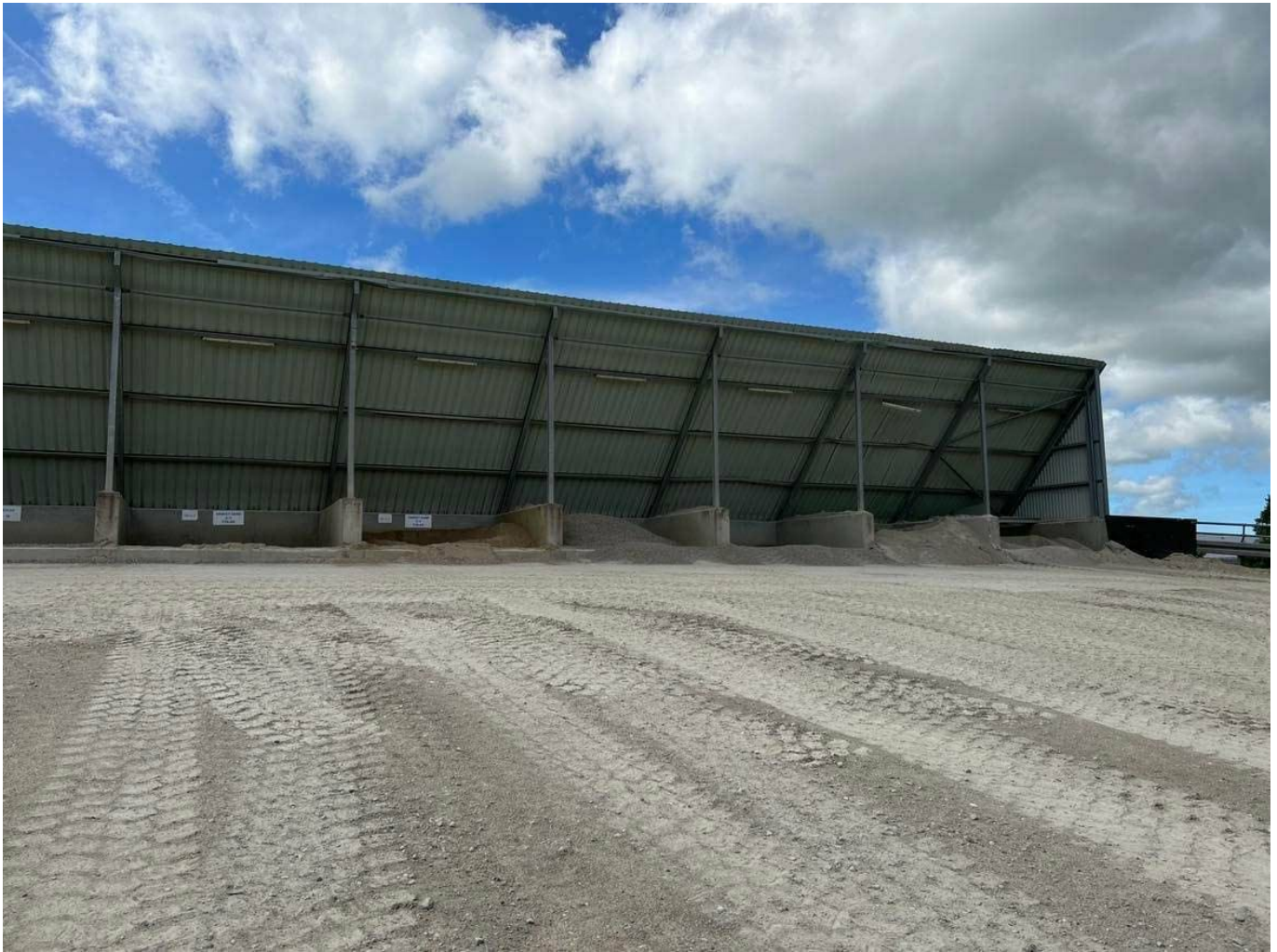
Figur 4 - Eksempel på materialesilo set fra toppen af konstruktionen
